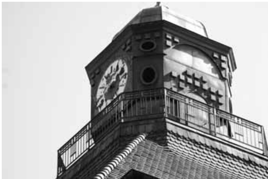
Der Zahn der Zeit hat am Thuner Pestalozzischulhaus genagt. Deshalb soll es ab 2013 vollständig saniert werden. (Foto: Heinz Schürch)
